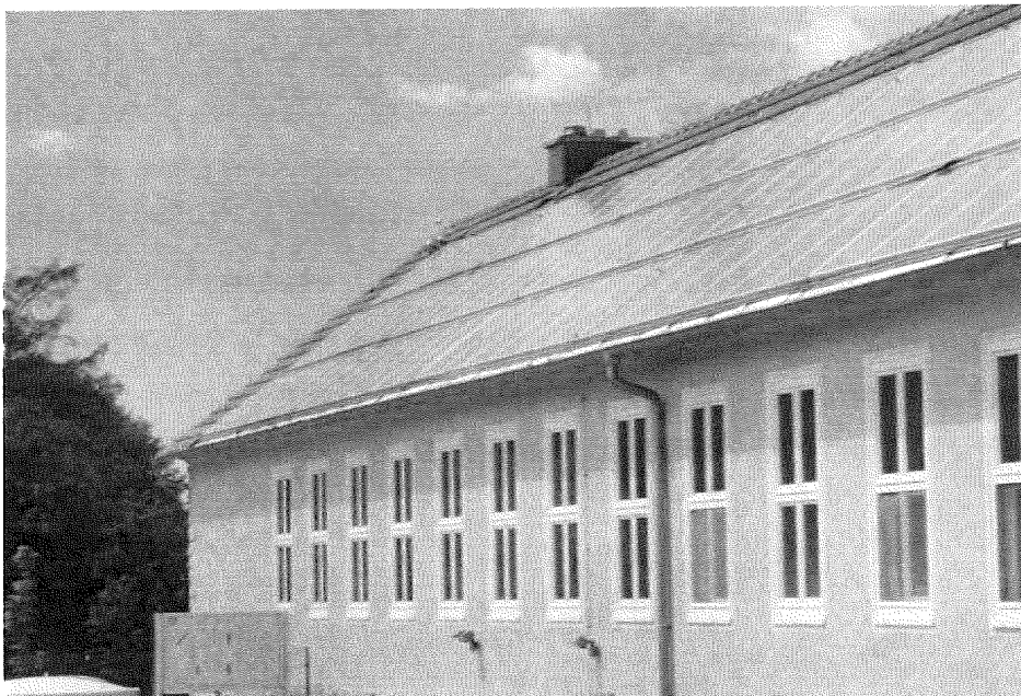
Das Kollektorfeld der CO 2 -reduzierten Heizung mit der Info-Tafel, an der sich die Gäste des Hauses über die Einsparung an fossilen Energieträgern informieren können.
